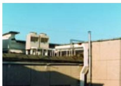
Системы СИТИ МУЛЬТИ серии Y, установленные в Саратовском филиале ЦБ РФ
