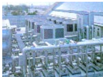
Сектор Мицубиси Электрик по сборке канальных кондиционеров
