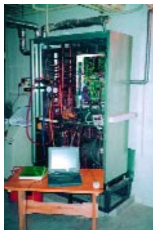
Компрессорно-конденсаторный агрегат, установленный в частном коттедже, г.Казань
